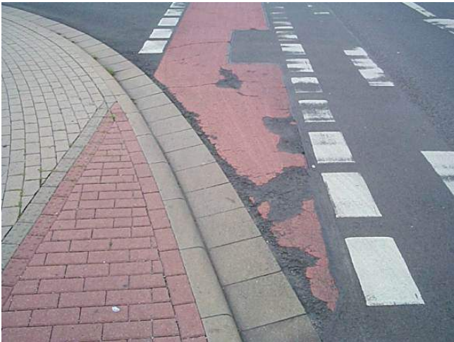
Vorhandener Radweg mit abgängiger Beschichtung
