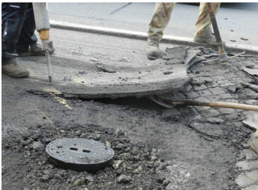
Der abgängige Asphaltbelag hat keinerlei Verklebung mit dem Pflaster.
