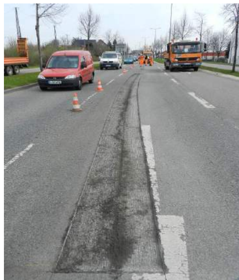
gefräster Nahtbereich (Riss ist auch im Binder erkennbar)
